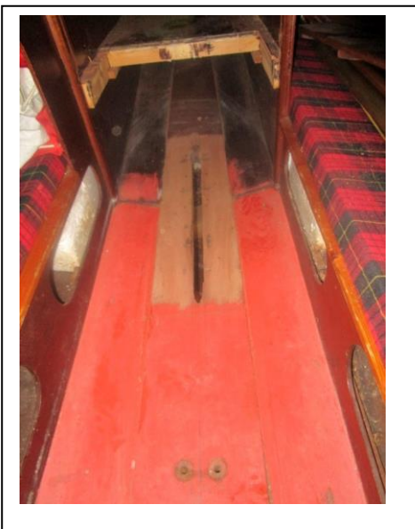
Der Schwertkasten samt Aufdoppelung und Schot sind entfernt. Es ist hier gut ersichtlich, dass der Innenkiel noch in gutem Zustand ist.
