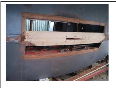
Das fehlende Stück ist wieder eingesetzt. Oben ist die Schäftung für die Aufnahme des Sperrholzbodens ersichtlich.
